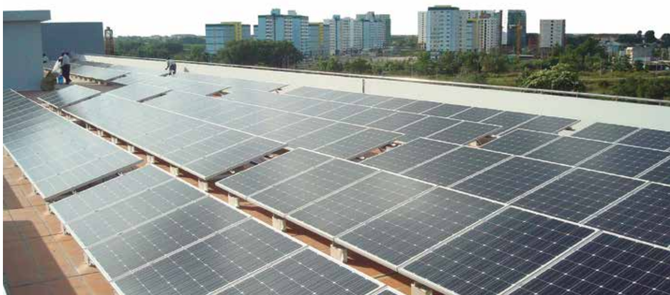
Hệ thống trên lưới kết hợp dự phòng 50.16 KWp tại Viện Môi trường và Tài nguyên - IER Tp.CMC (Nguồn: Redsun 2013)
