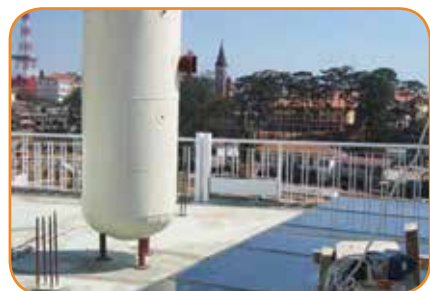
Dự án lắp đặt hệ thống sản xuất nước nóng bằng năng lượng mặt trời tại Tp. Đà Lạt (Nguồn: www.enerteam.org)
