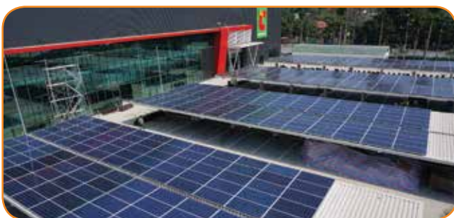
Dự án pin mặt trời Việt Nhật, 215kWp - Việt Nam (Nguồn: Artelia 2013)
